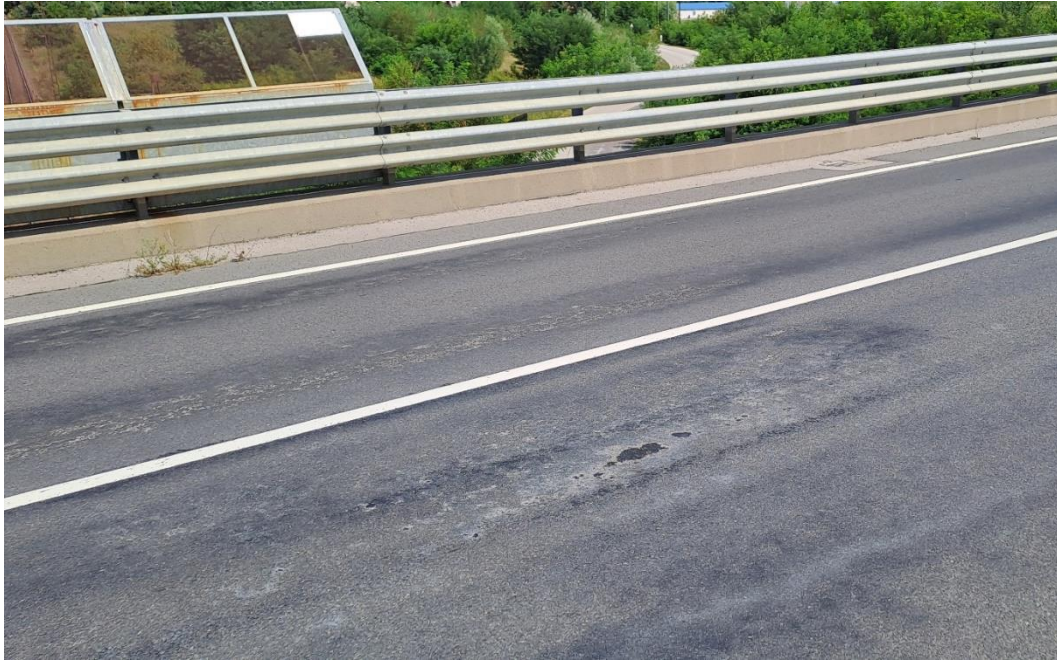
2. ábra: Aszfalt burkolatú pályaszerkezetből kilépő víz (szerző felvétele).
