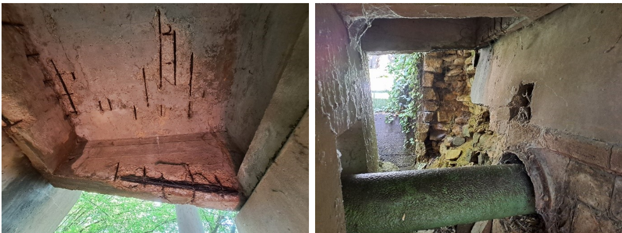
9-10. ábra: A korrodált rövidkonzol és csatlakozó támfal megbomlott kőfalazata (szerző felvétele).
