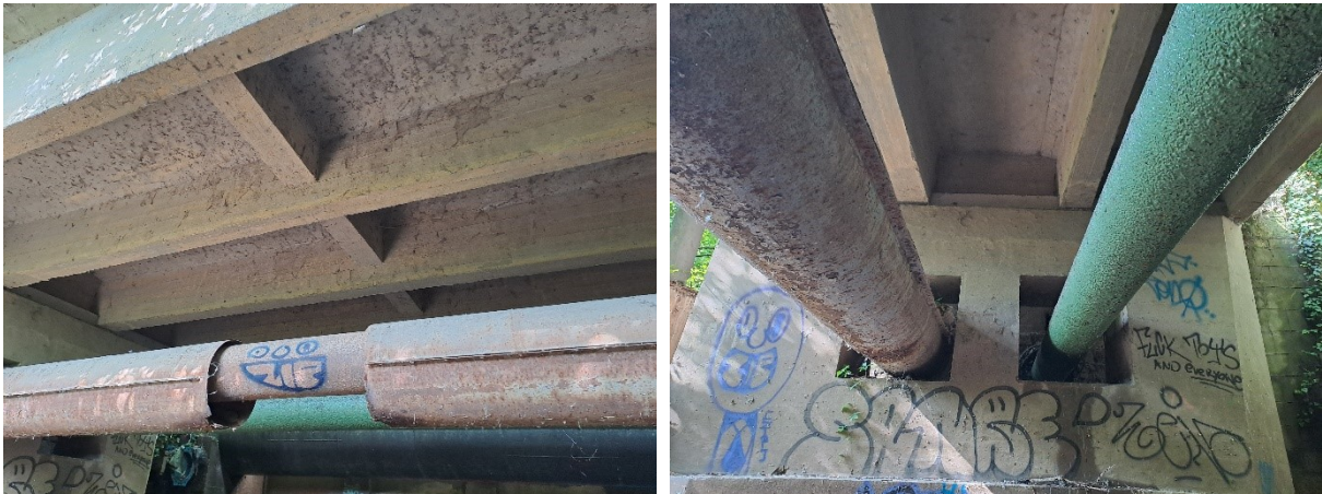
7-8. ábra: A középső nyílásban tökéletesen átázásmentes felszerkezet és a pillér az átvezetett ivóvíz vezetékekkel (szerző felvétele).
