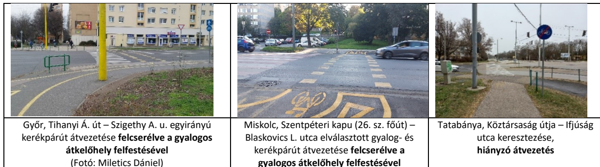
13. ábra. Jelzőlámpás szabályozású kijelölt gyalogos-átkelőhelyekkel közös átvezetések felcserélve, illetve az átvezetés hiánya.
