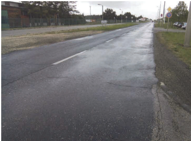
6. Ábra. Süppedés és keresztirányú repedés a burkolaton
