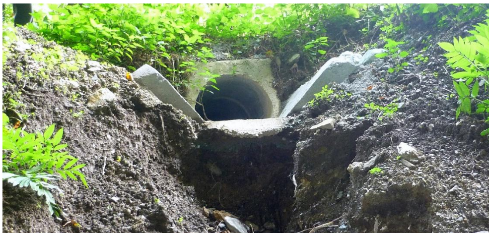
6. ábra: Erózió a csőáteresztő kifolyási pontjánál
